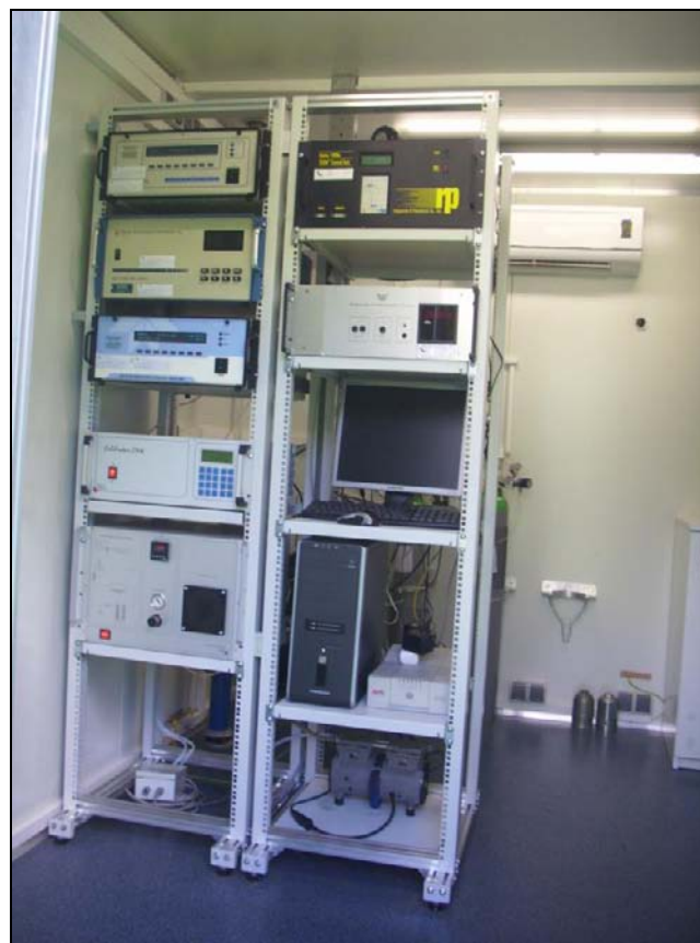
Ryc.5. Wnętrze nowego kontenera na stacji AM1
