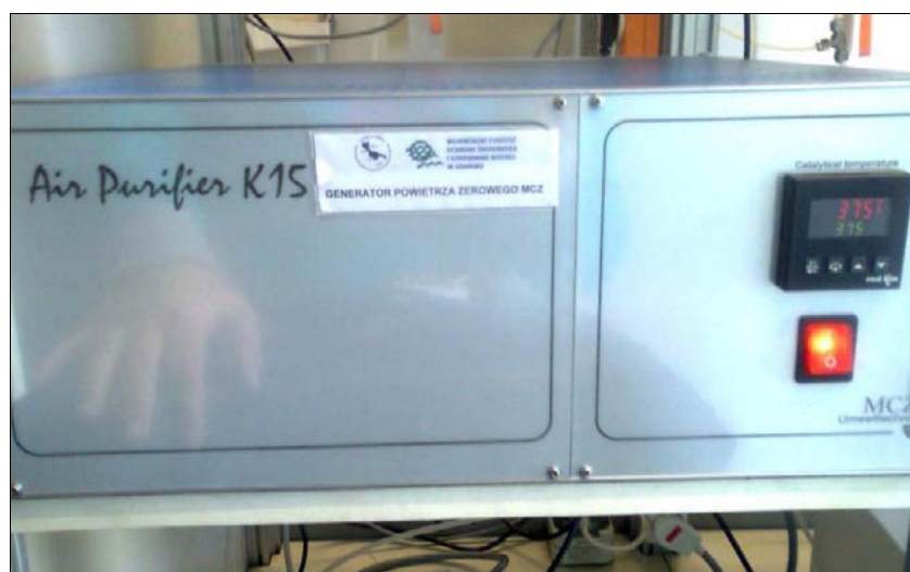
Ryc.3. Nowy generator powietrza zerowego K15 na stacji AM10.
