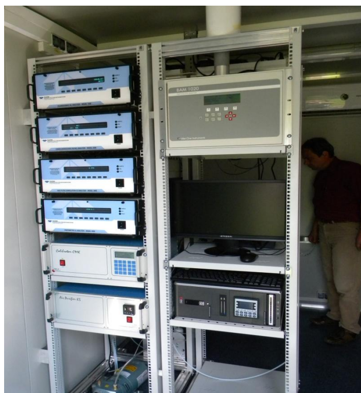
Ryc.7. Wyposażenie stacji pomiarowej
